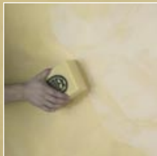
6. Im Anschluss wird das PANDOMO-Steinöl dünn aufgetragen und überschüssiges Öl mit einem fusselfreien Lappen abgerieben.
