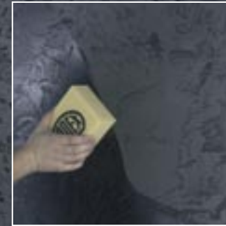
5. Im Anschluss wird das PANDOMO-Steinöl dünn aufgetragen und überschüssiges Öl mit einem fusselfreien Lappen abgerieben.
